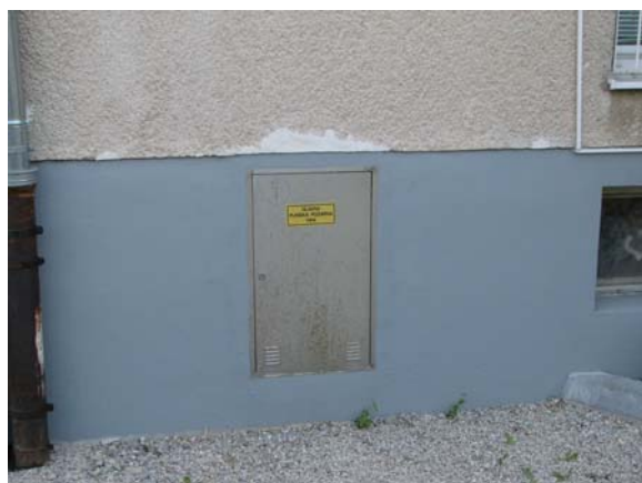
Slika 7: Prikluček za zemeljski plin na objektu Poštna 7b
