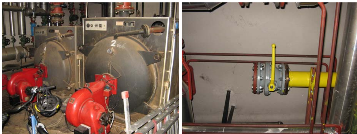
Slika 20: Kotla na ELKO in zemeljski plin kotlovnici v osnovni šoli Ivana Cankarja na Lošci
