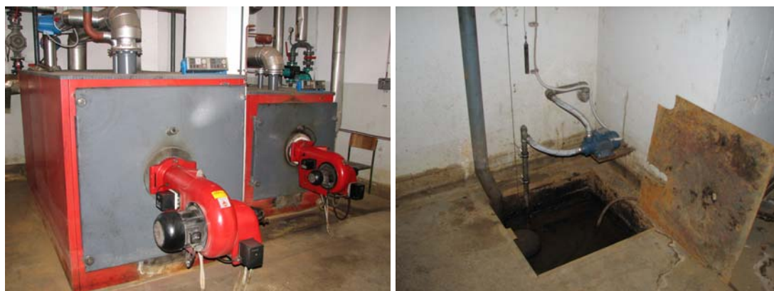
Slika 5: Skupna kotlovnica za ogrevanje poslovno stanovanjskih objektov na lokaciji Gradišče 13a
