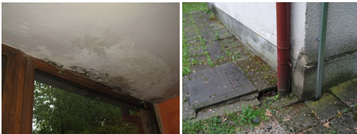
Slika 9: Puščanje strehe in razpoke na fasadi osnovne šole Ivana Cankarja na Lošci
