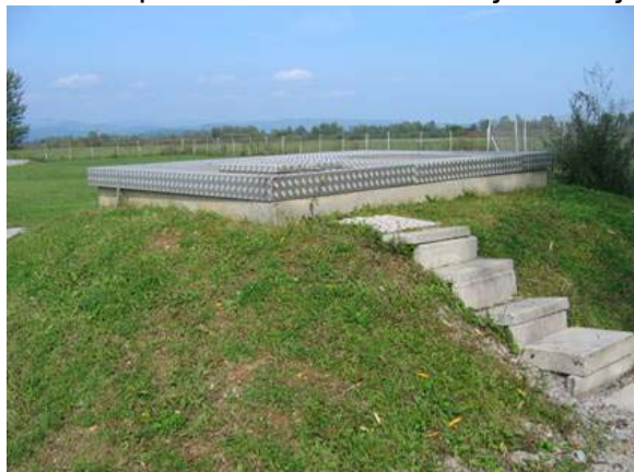
Slika: Črpališče Borovniški vršaj – vodnjak s potopno črpalko
