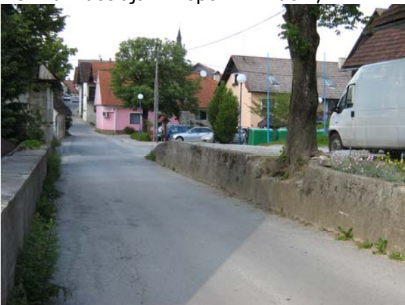
Ožina z dotrajanim opornim zidom,
