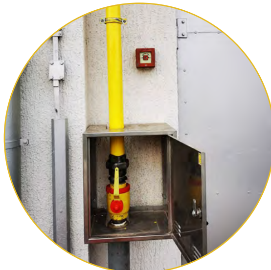
Glavna plinska požarna pipa
