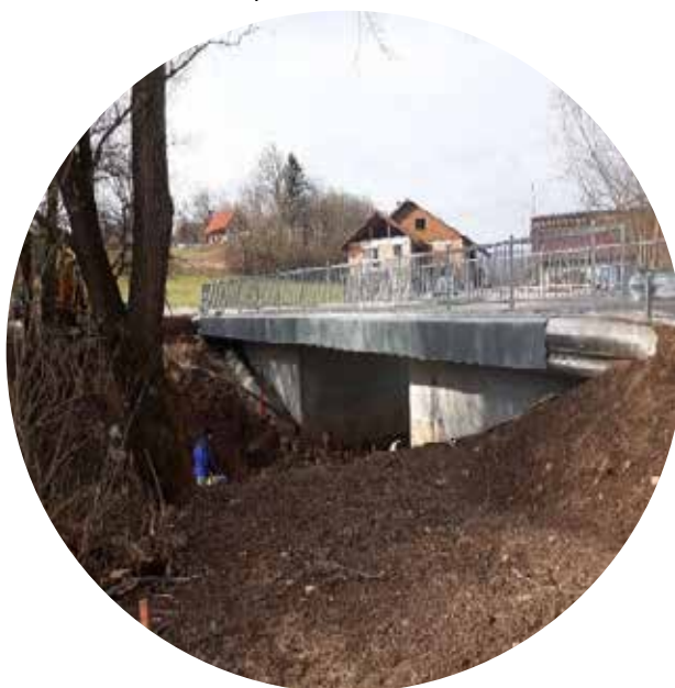
Vodovod preko mostu Črna mlaka
