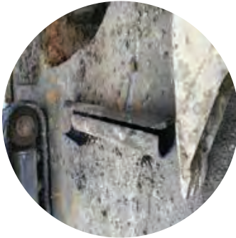
Poškodovana azbestna cev
