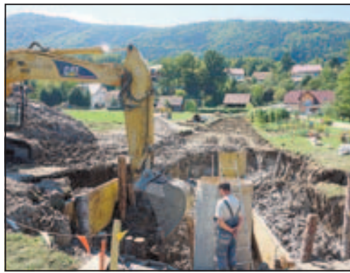
Kanalizacijsko omrežje se bliža čistilni napravi.
