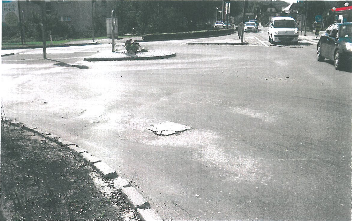
Slika 2: Poškodovano vozišče na izvozu iz AC
